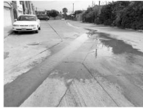
las alcantarillas se encuentran oxidadas.
