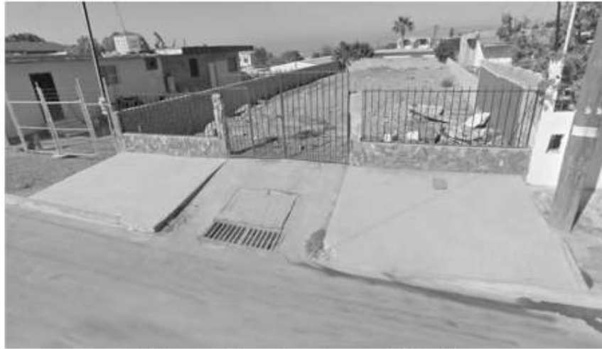
Alcantarilla antes de ser obstruida
