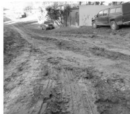
problemas en la calle.
