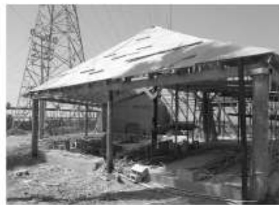
La marisquería debajo de las torres de alta tensión de la CFE.
