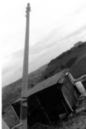
El poste está a punto de caer a la casa de Alfredo Montes y su familia.
